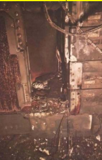
Section intérieure du MC après l'incendie
