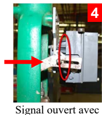
Signal ouvert avec couplage endommagé
